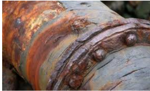
Рис. 1.4. Зовнішній вигляд високотемпературної корозії
