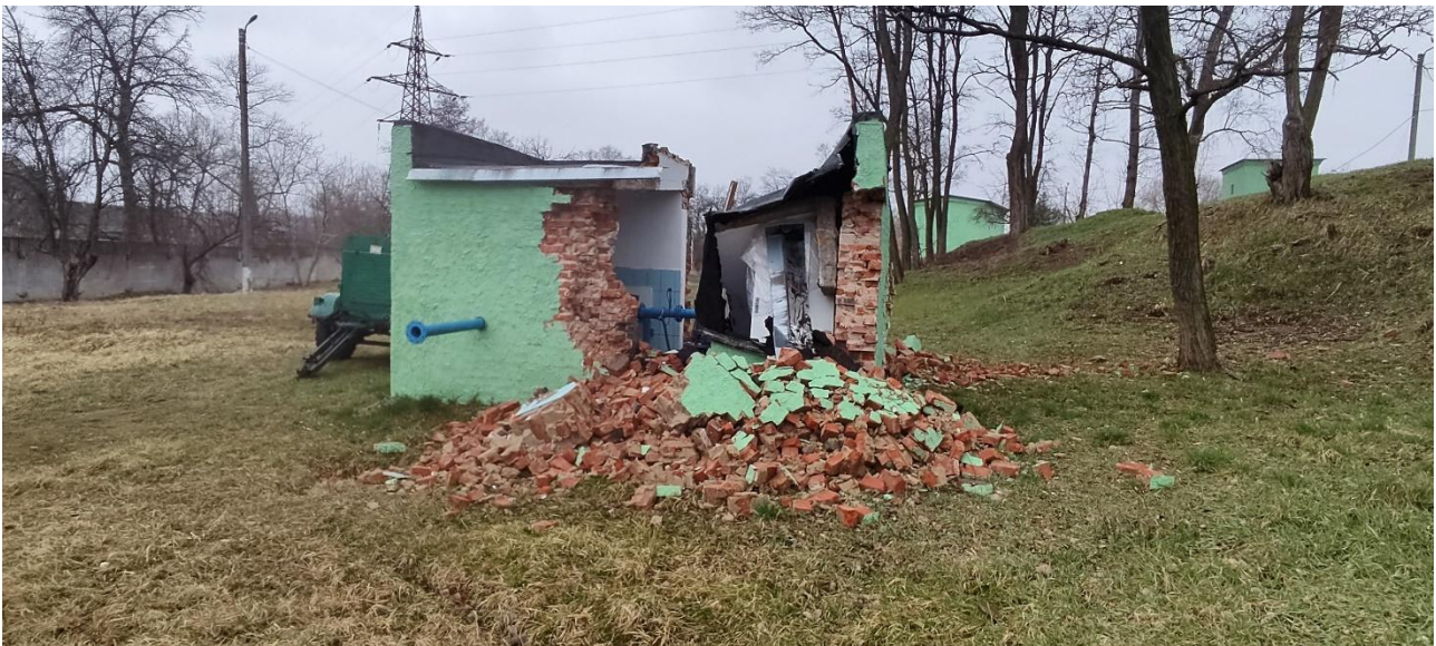
Рис. 1. Артезіанська свердловина №3 на території насосної станції водопроводу № 1 «Ялівщина» КП «Чернігівводоканал»
